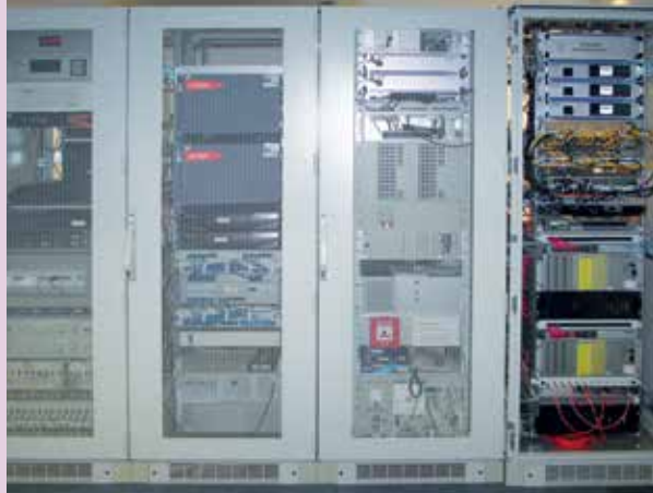
Teilausschnitt der technischen Zentrale in der Leitstelle
