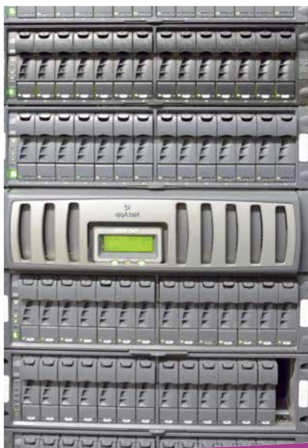
Teilansicht eines zentralen Speichersystems
