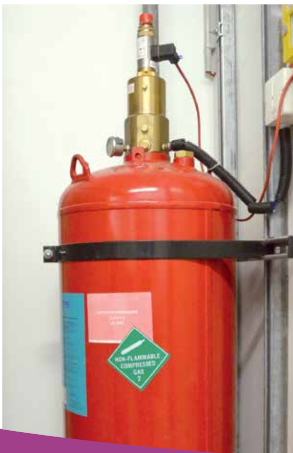
Ein Teil der CO 2 Löschanlage neuer Serverraum
