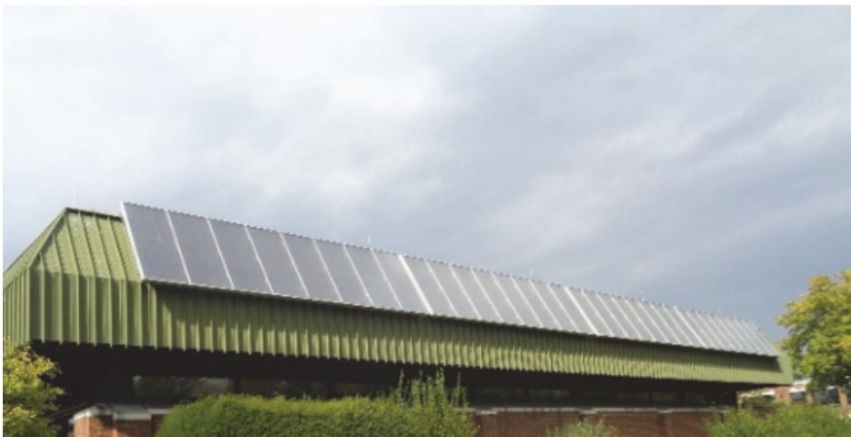
Thermische Solaranlage am Berufskolleg Ahlen
