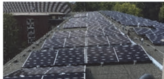
Photovoltaikanlage Förderschule Warendorf
